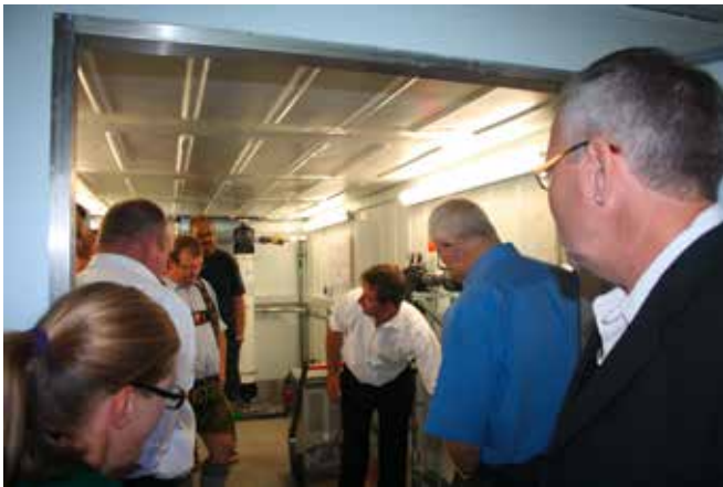
Hausmeister Anton Streidl (Mitte, gebückt) demonstrierte die Funktionen der Wasseraufbereitungsanlage bei der Einweihungsfeier.
